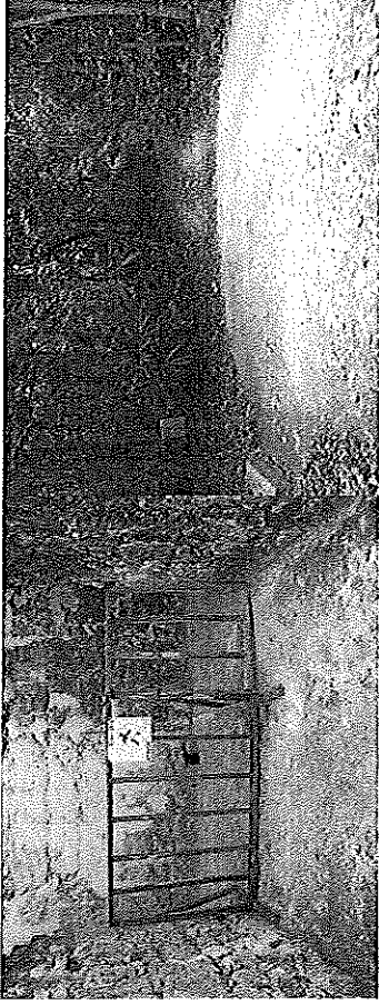
Fig.1: barreras y rótulos desgastados. Fig.2: rótulos direccionales evaluados.
